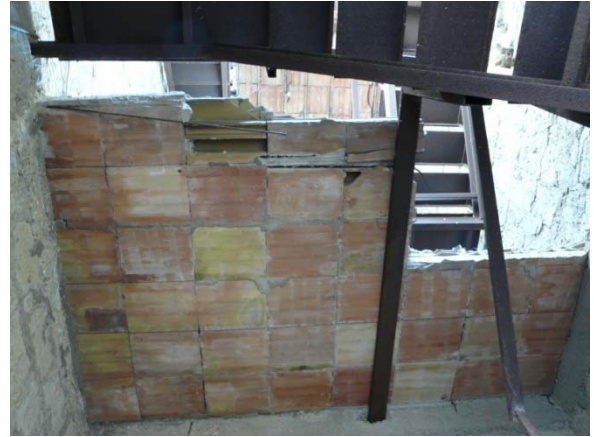
Foto 13: Particolare dei solai crollati del campanile
